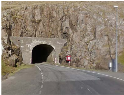
Mynd 43: Gamli tunnilin til Hvalbiar eigur at vera brúktur til ábæra ferðslu. (Google Street).
